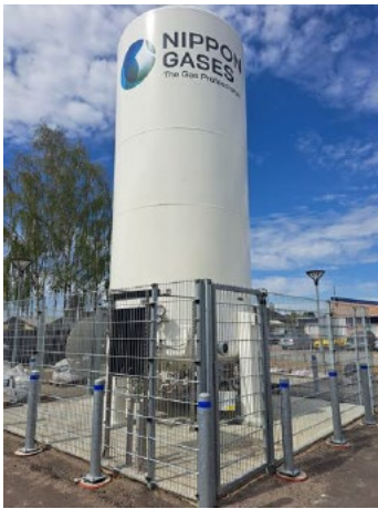
Eksempel på tank, der skal leveres CO 2 til 1-2 gange om ugen
